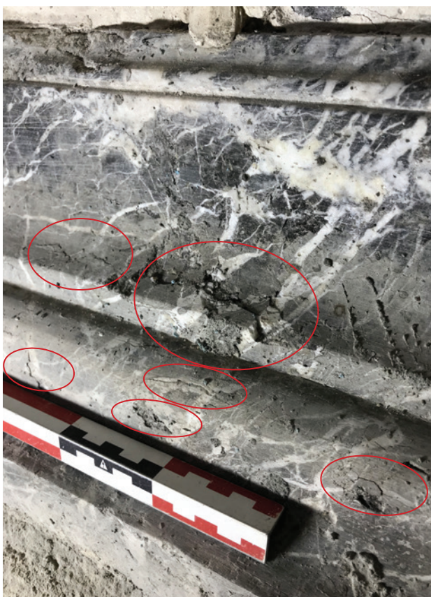
Effritement de la pierre en face avant (au centre), à la base du coffre.
