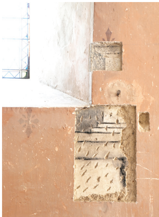
Sondage N°5, socle du pilier de droite. Entablements sous la baie, créant visuellement de la profondeur autour de celle-ci. A droite en en-dessous de la baie, l'enduit a été bûché.
