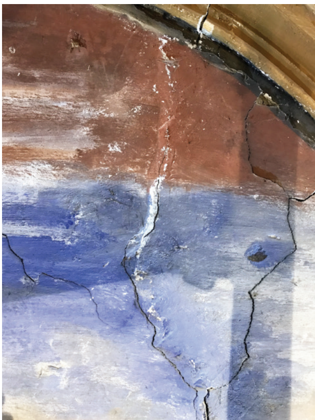
Repeints étendus (bleu outremer et Terre de Sienne brûlée) autour des fissures colmatées au plâtre (Saint Pierre).
