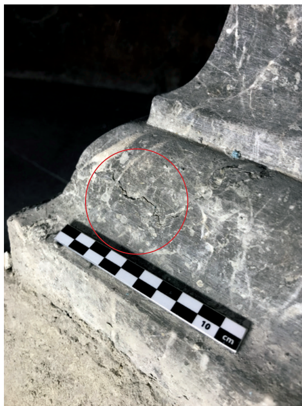
Effritement de la pierre en face avant (partie gauche)
