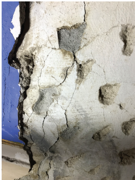
Solins temporaires de maintien, sondage N° 13 Les enduits sont très instables et doivent être consolidés par des injections de coulis à base d'hydroxyde de calcium.
