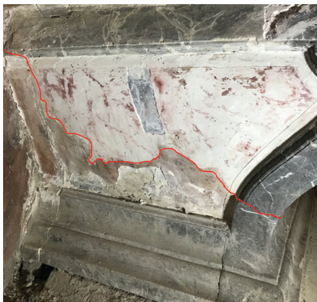
Côté gauche de l'autel, zone de cristallisation de sels avec boursoufflures et éclatement des matériaux. La pierre à la base est couverte d'efflorescences.
