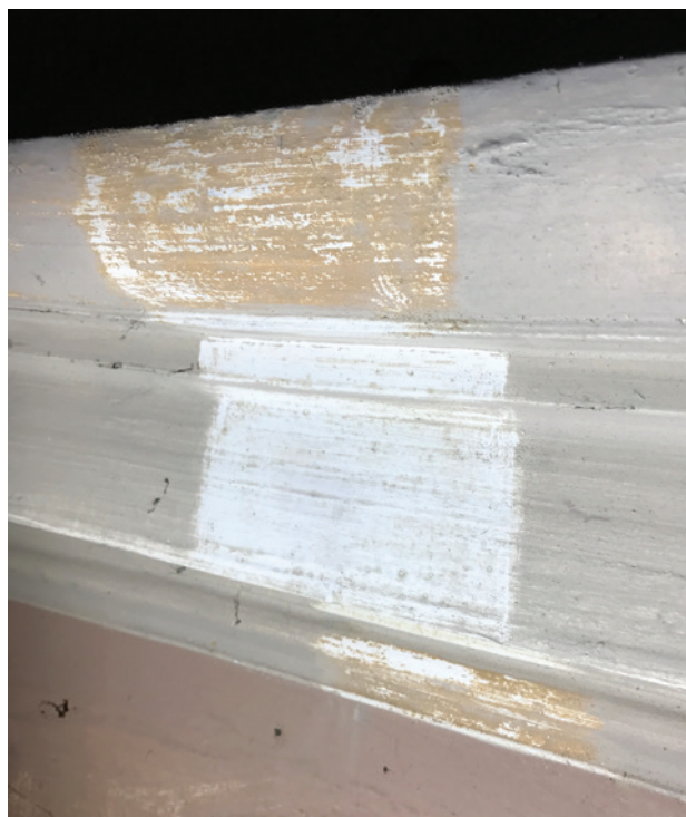
Sondage N° 23, polychromie originale de la corniche
