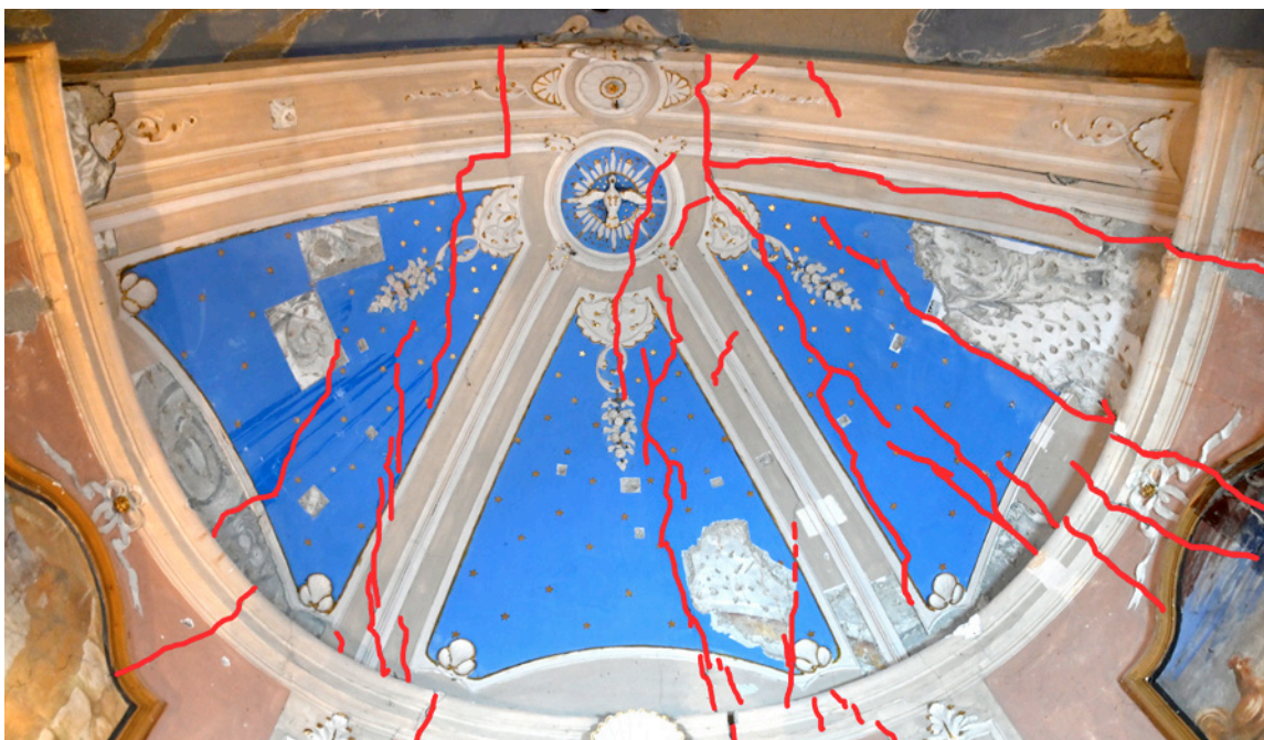
Localisation des fissures principales
