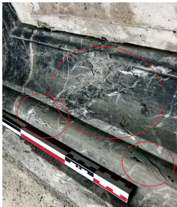
Effritement de la pierre en face avant (partie gauche)
