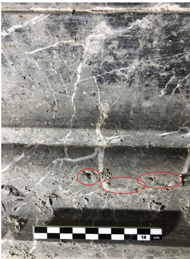
Laitances et résidus de mortier de ciment, effritement de la pierre, à la base du côté droit de l'autel
