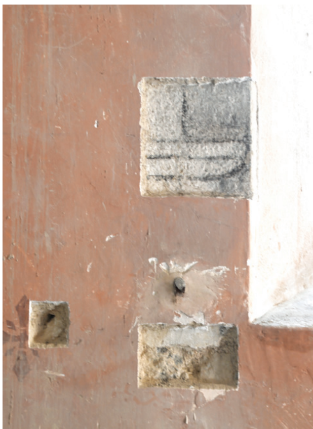
Baie 2 - Sondages N°7/8/9 - Rupture d'enduit au niveau de l'appui. L'enduit est lacunaire en plusieurs points dans la nef.
